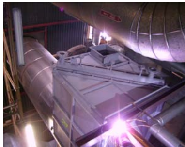
Montage vor Ort
